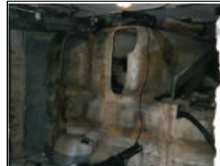
Batterietankanlage mit defekten Behältern
