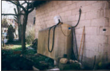
Unzulässige Aufstellung eines GKF-Tanks
