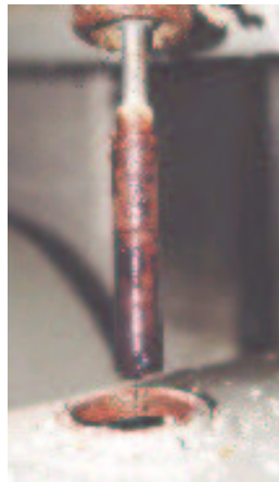
Bohrungen sind durch Belag verstopft. Nicht mehr funktionstüchtig !
